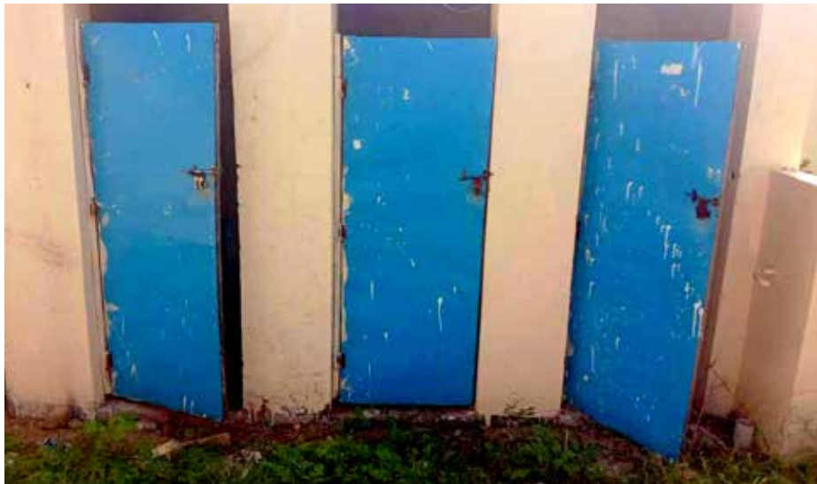
Die alten Toiletten, in denen immer wieder Schlangen oder Skorpione entdeckt wurden.
